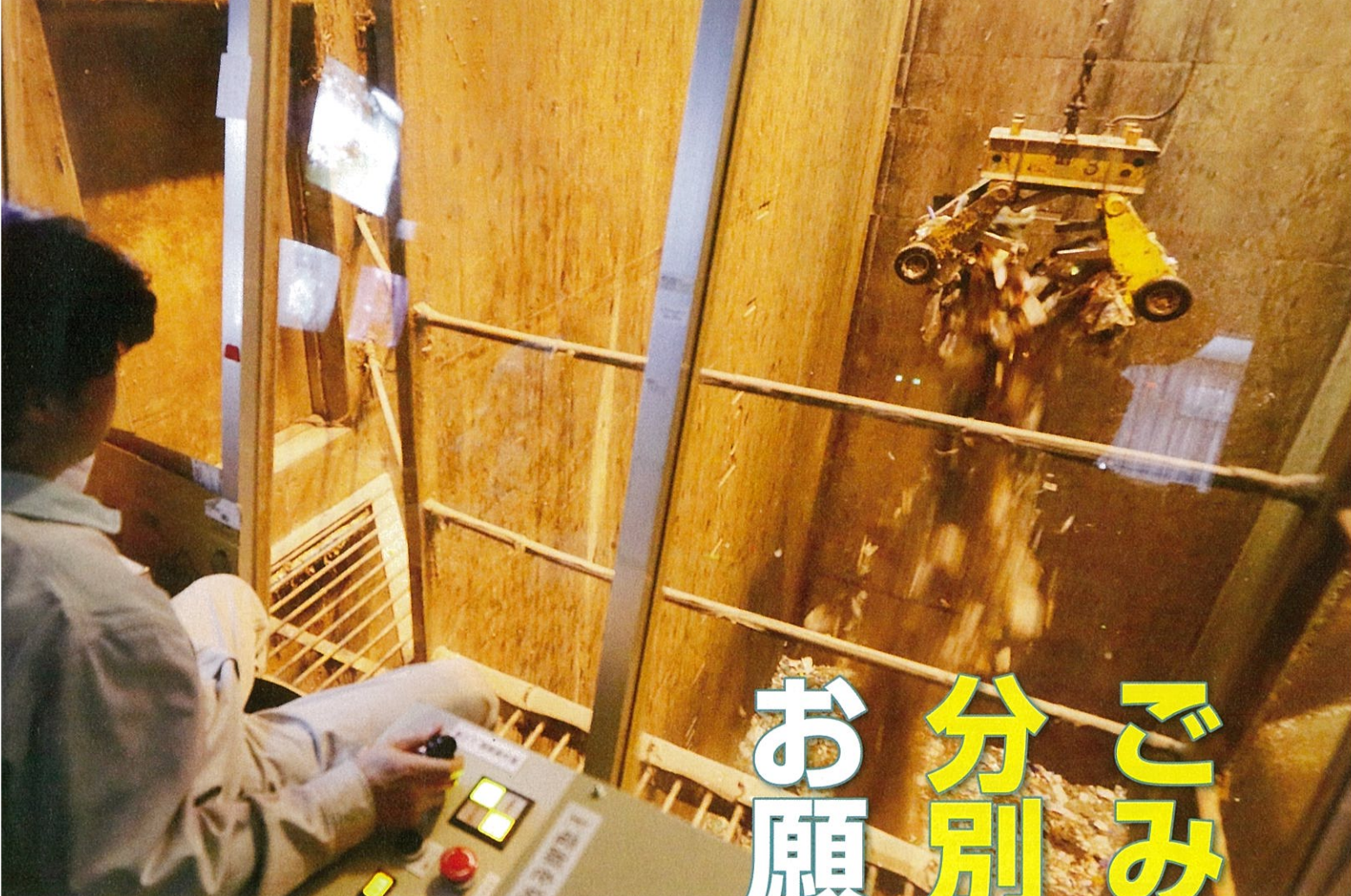
二戸地区クリーンセンターの焼却炉。ごみ投入口から投入されたごみは、ごみピット内でクレーンによって かくはん 攪拌され、性状を均質化する。
