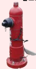
しょう か せん 消火栓
