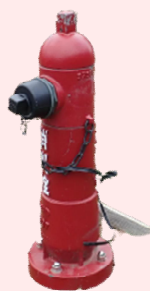
しょう か せん 消火栓
